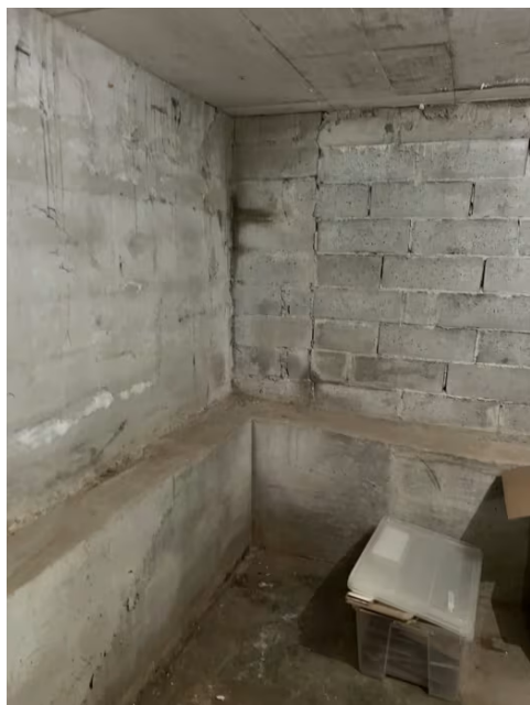
Fukt, kalk/saltutslag påvist i grovkjeller.
