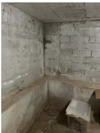
Fukt, kalk/saltutslag påvist i grovkjeller.
