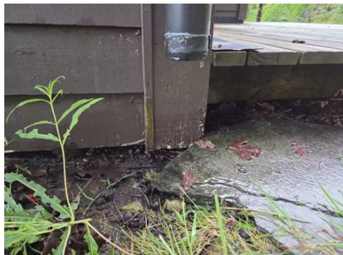
Nedløpet er avsluttet over bakken, vann renner ned mot grunnmur.
