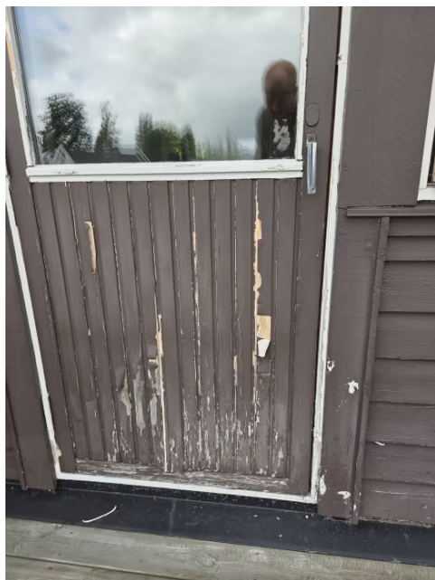
Slitt og skadet balkongdør
