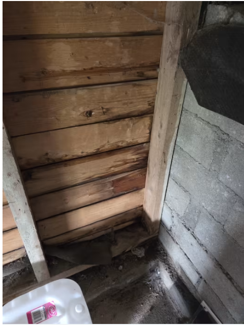
Fuktskjolder kan sees på innsiden av kledningen her.
