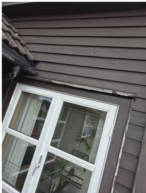
Slitasje stedvis på utvendig kledning.
