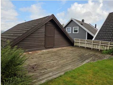
Skjev og råteskadet terrasse.
