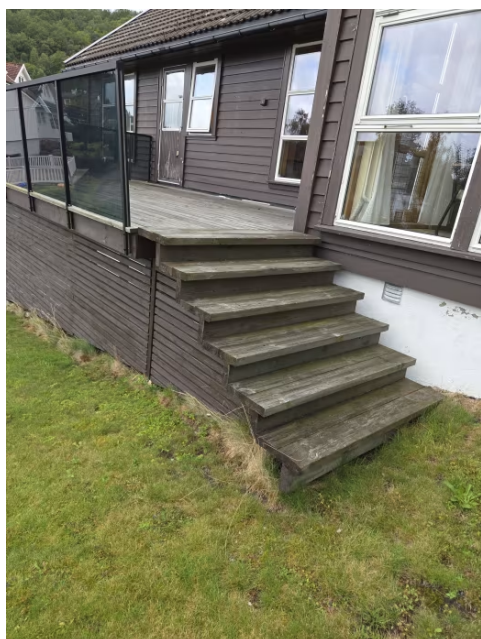
Utvendig trapp mangler rekkverk.
