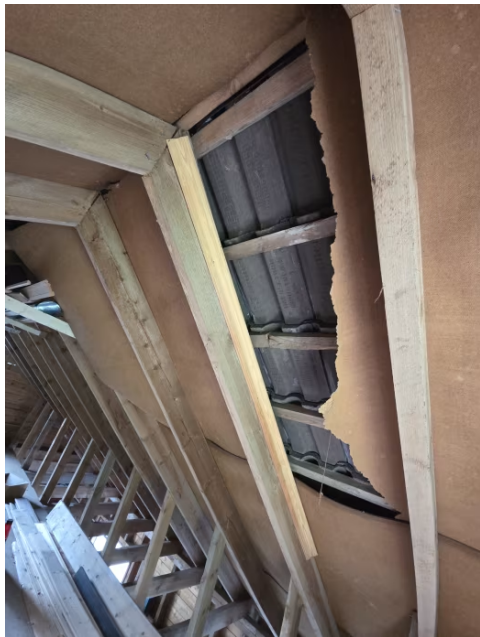
Skade/mangel på undertaket.
