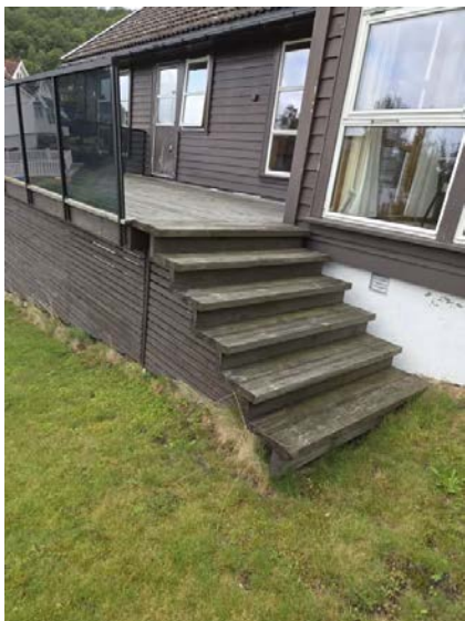
Utvendig trapp mangler rekkverk.
