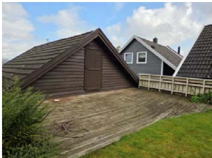
Skjev og råteskadet terrasse.
