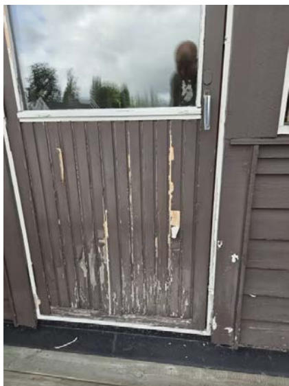
Slitt og skadet balkongdør
