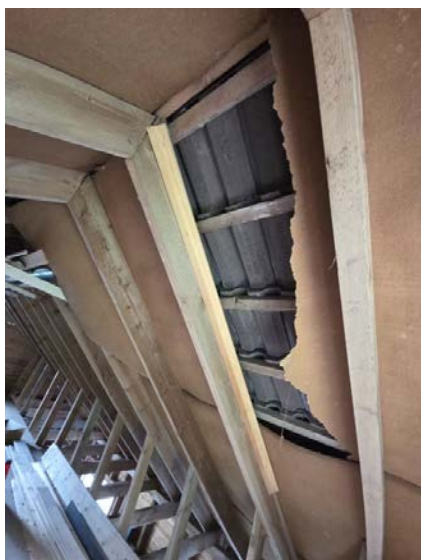
Skade/mangel på undertaket.
