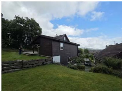
Det er den lødde muren som mangler rekkverk.
