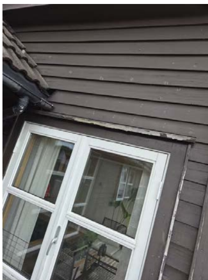
Slitasje stedvis på utvendig kledning.
