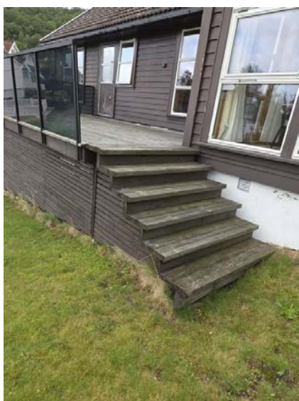
Utvendig trapp mangler rekkverk.
