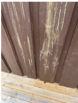
Mye harpiks i enkelte kledningsbord.
