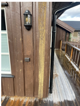
Mye harpiks i enkelte kledningsbord.
