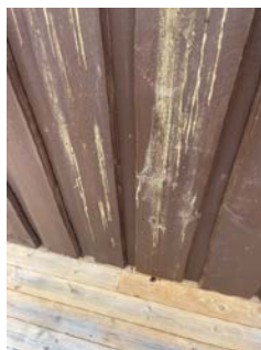
Mye harpiks i enkelte kledningsbord.
