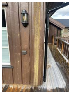
Mye harpiks i enkelte kledningsbord.
