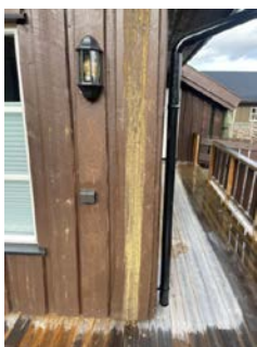
Mye harpiks i enkelte kledningsbord.
