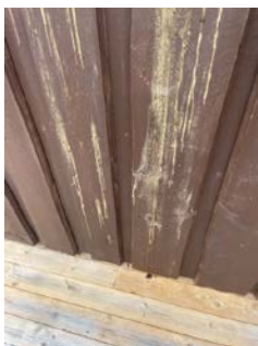
Mye harpiks i enkelte kledningsbord.
