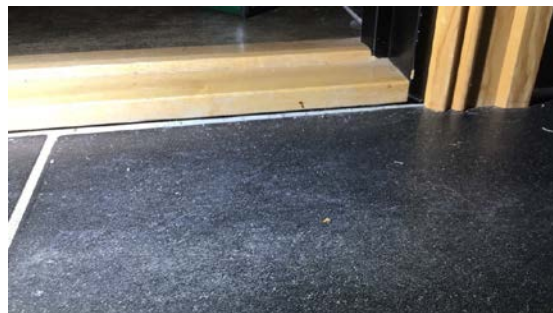
Mangler oppkant under dør
