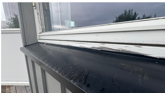
Enkelte vinduer er noe utvendig værslitt.
