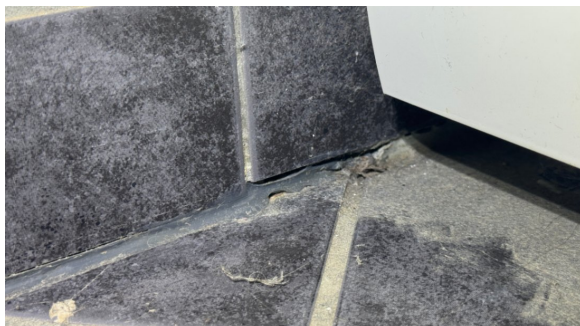
Sprekker i fug mellom vegg/gulv.-
