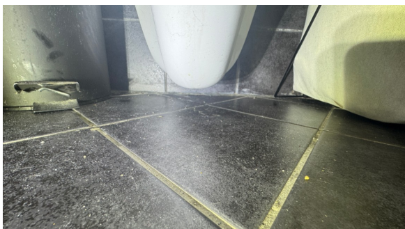
Manglende dreneringsåpning under den innebygde sisternen.
