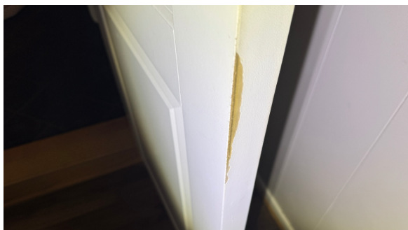
Slitasje/skade på dørblad.
