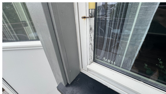
Enkelte vinduer er noe utvendig værslitt.
