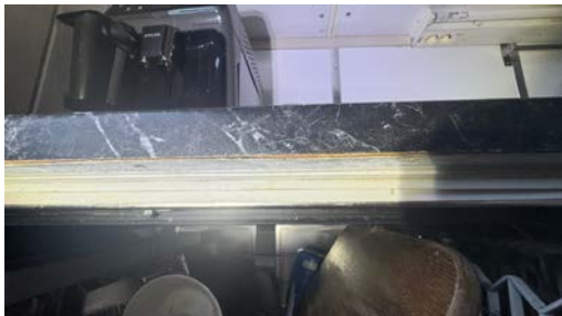
Fuktsvell i benkeplate over oppvaskmaskin
