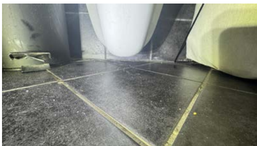
Manglende drensåpning under den innebygde sisternen.
