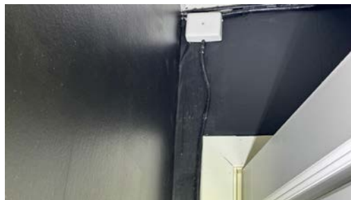
Det er påvist tegn til ufagmessig arbeider på det elektriske anlegget.
