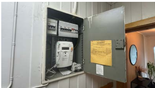
Kontroll av el-skap og kursfortegnelse.
