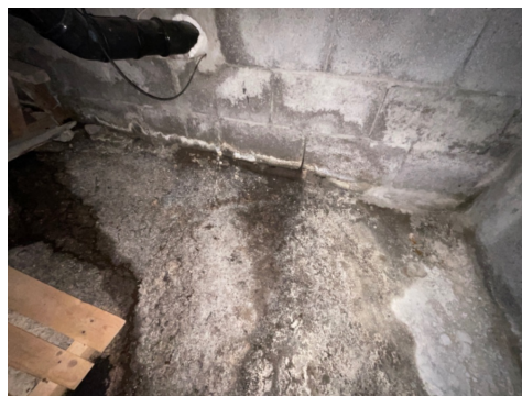
Synlig vann inn på fjell i krypkjeller
