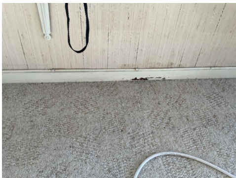
Avvik på gulvlist og vegg under stuevinduer
