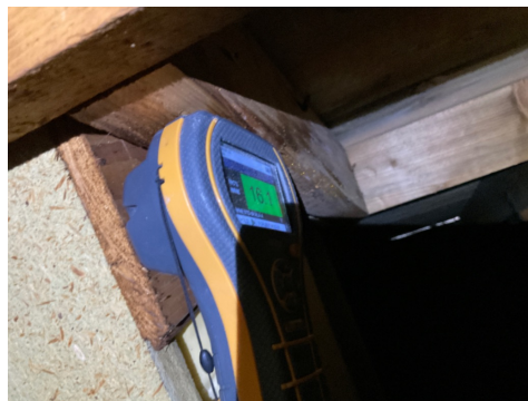
Fuktmåling i trekonstruksjoner rundt luftekanal
