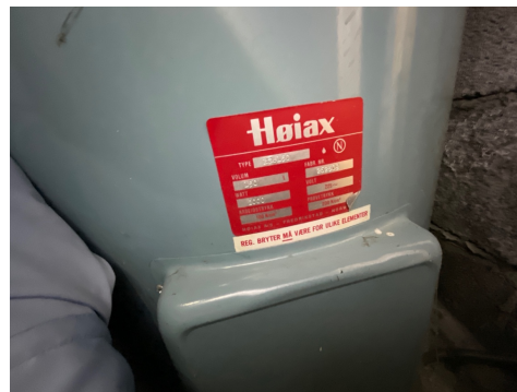
Varmtvannstank i uinnredet kjellerrom
