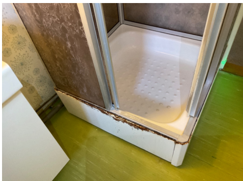
Rust på dusjkabinett
