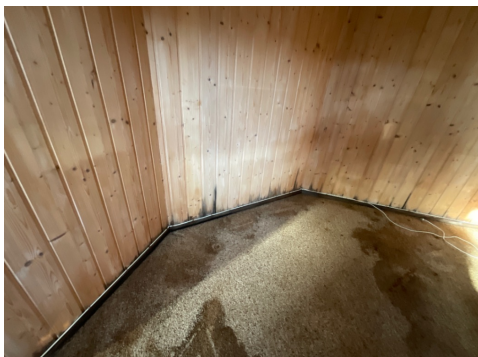
Synlig fukt og råte i trepanel i kjeller
