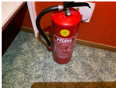
Boligen har røykvarsler montert gangen, i kjellerstuen og branslukkingsapparatet er plassert i boden
