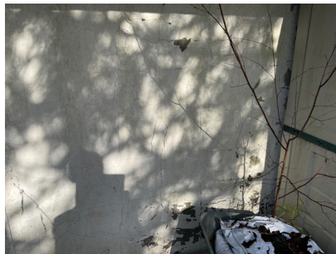
Riss utvendig på murpuss
