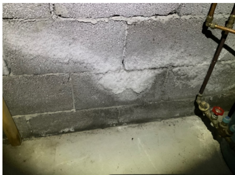
Saltutslag på grunnmur innvendig
