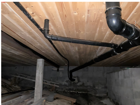
Synlige vann og avløpsledninger i krypkjeller
