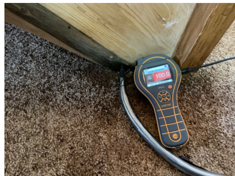
Fuktmåling i trappevange
