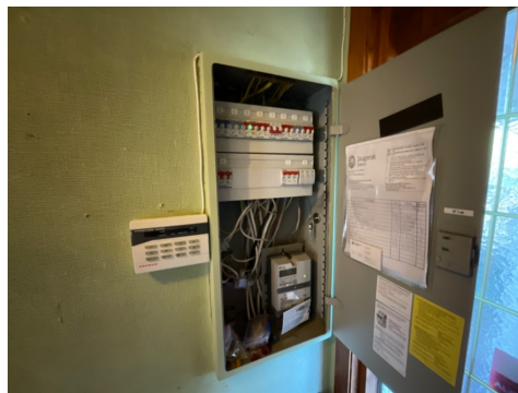
Sikringsskap i entreen
