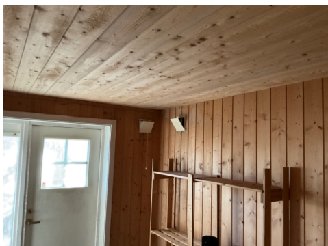
Luftventiler i vegg i kjeller
