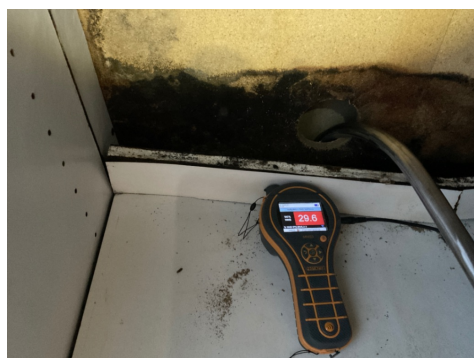
Hulltaking i kjøkken vegg 9. mars 2026
