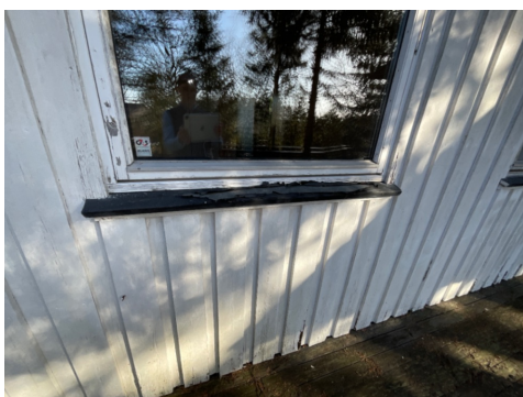
Beslag på soveromsvinduet
