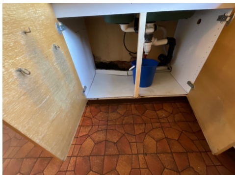
Lekasje under kjøkkenvask
