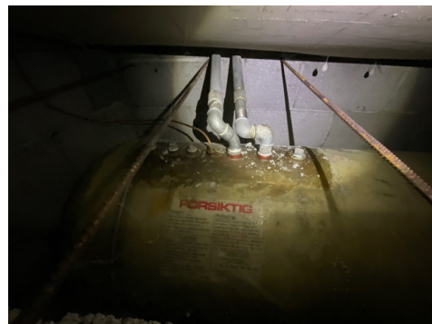
Oljetank i krypkjeller
