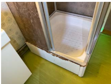
Rust på dusjkabinett
