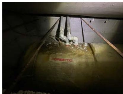
Oljetank i krypkjeller
