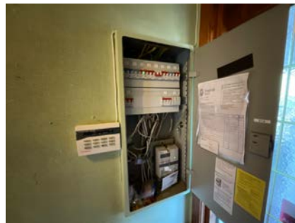
Sikringsskap i entreen
