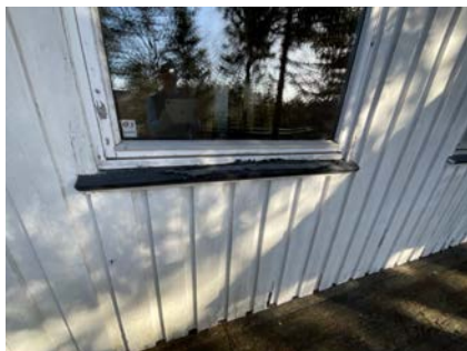
Beslag på soveromsvinduet
