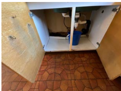
Lekkasje under kjøkkenvask
