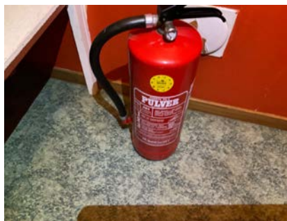
Boligen har røykvarsler montert gangen, i kjellerstuen og branslukningsapparatet er plassert i boden
