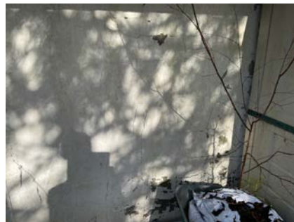
Riss utvendig på murpuss
