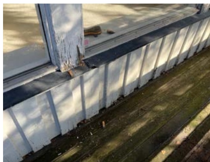
Utvendig råte rundt stuevinduet og i bunnen av utvendig trepanel.
