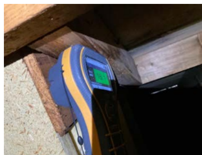
Fuktmåling i trekonstruksjoner rundt luftekanal
