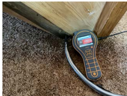
Fuktmåling i trappevange
