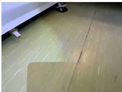
Sprekk i vinylbelegg
