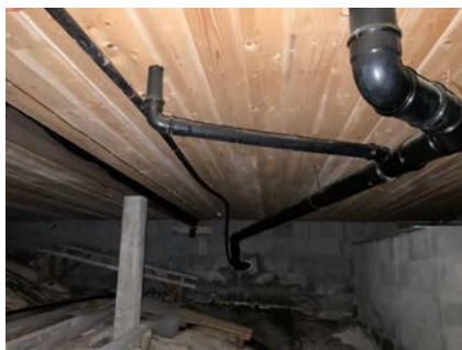
Synlige vann og avløpsledninger i krypkjeller
