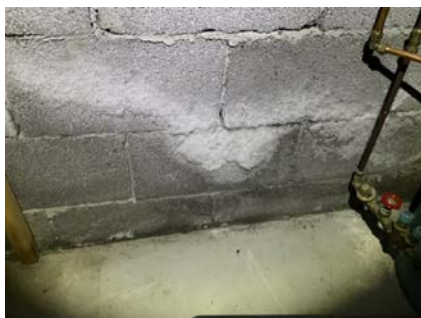
Saltutslag på grunnmur innvendig
