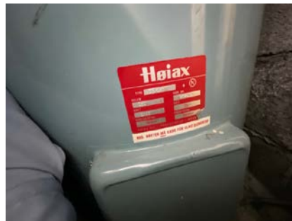
Varmtvannstank i uinnredet kjellerrom
