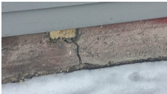
Eksempel på sprekk i grunnmur.
