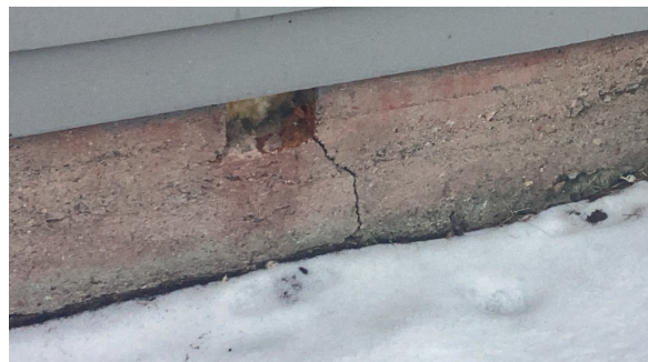
Eksempel på sprekk i grunnmur.
