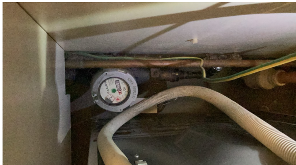
Vanninntak med stoppekran på bad.
