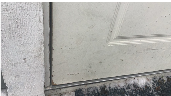
Eksempel på slitasje.
