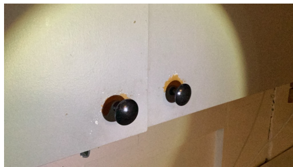
Eksempel på slitasje.
