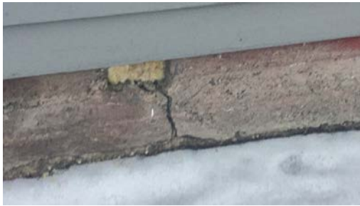
Eksempel på sprekk i grunnmur.
