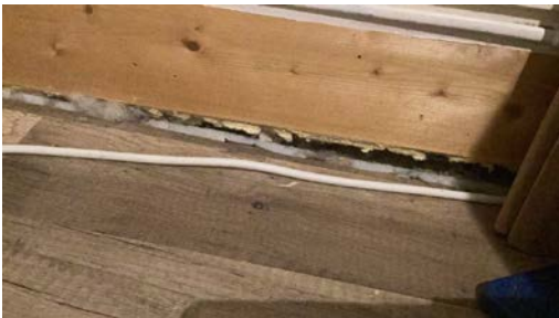
Glippe mellom gulv og vegg på soverom i tilbygg.
