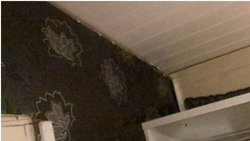
Eksempel på manglende listverk.
