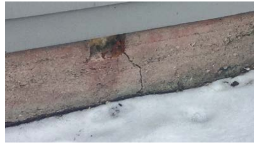
Eksempel på sprekk i grunnmur.
