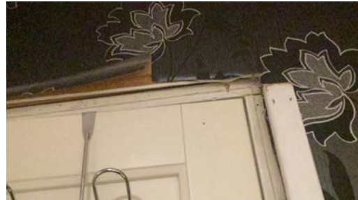
Tapet som løsner og manglende listverk.
