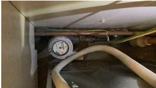
Vanninntak med stoppekran på bad.
