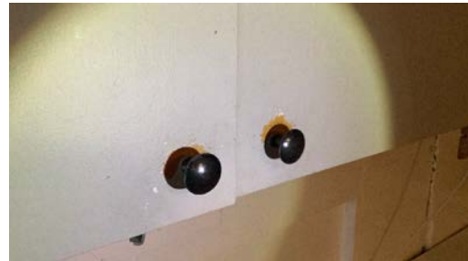
Eksempel på slitasje.
