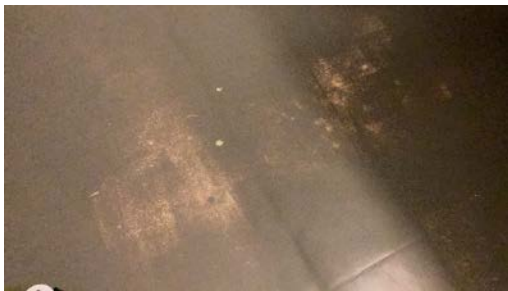
Slitasje på gulv.
