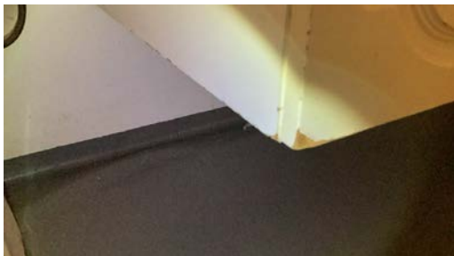
Slitasje på innredning.
