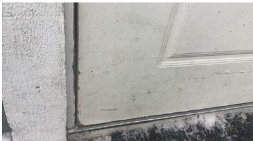
Eksempel på slitasje.
