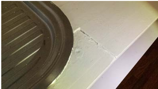
Skjøt på benkeplate
