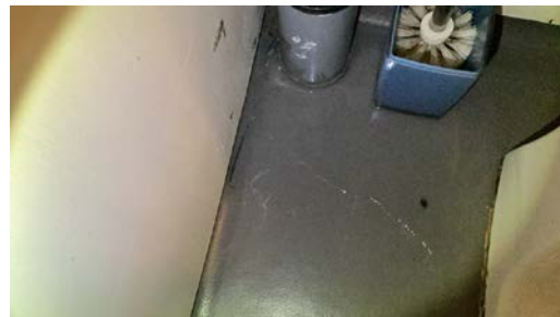
Vann på gulv rundt toalett.
