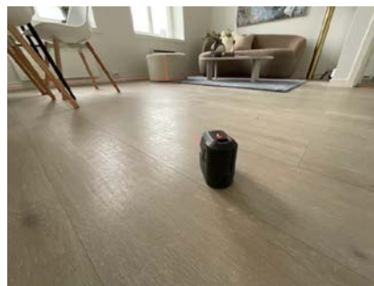
Nivellering stue/kjøkken, avvik ca. 10-20 mm
