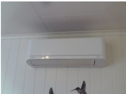
Varmepumpe i stue.
