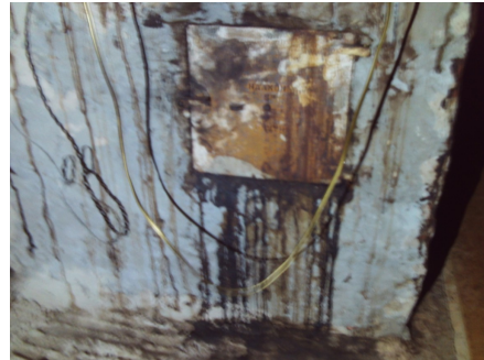
Feierluke på øverste loftet. Noe renne merker etter sotvann.
