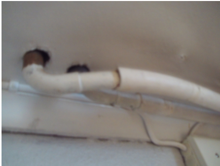
Avløpsrør i fra kjøkken.
