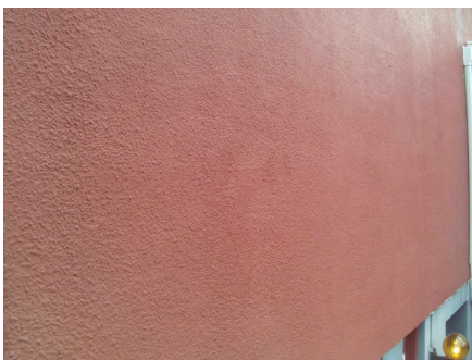
Deler av pusset fasade.
