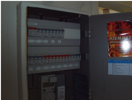
Sikringskapet er plassert i gangen på loftet.
