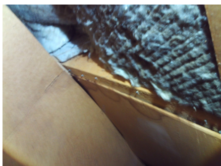
Ingen luftespalte i mellom isolasjon og undertaket på øverste loftet.
