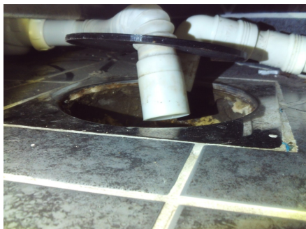
Sluk under dusjkabinett.
