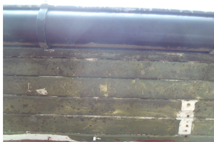
Ingen luftespalter i gesimser.
