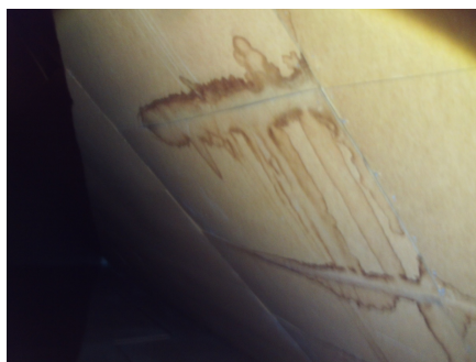
Kondens/fuktmerker på huntonittplater på øverste loftet.
