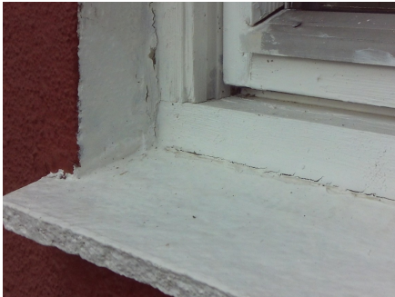
Noe slitasje på utvendig karm og ramme.
