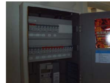
Sikringsskapet er plassert i gangen på loftet.
