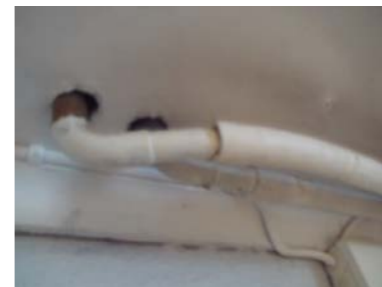
Avløpsrør i fra kjøkken.
