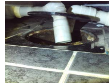
Sluk under dusjkabinett.
