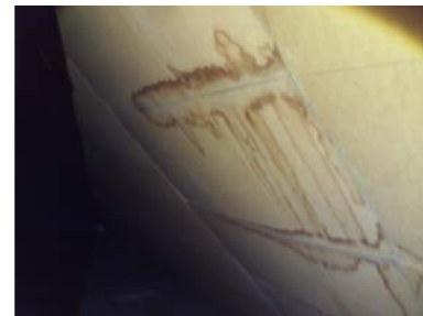
Kondens/fuktmerker på huntonittplater på øverste loftet.
