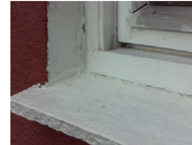
Noe slitasje på utvendig karm og ramme.
