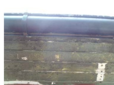
Ingen luftespalter i gesimsler.
