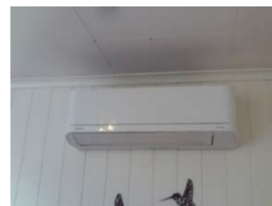
Varmepumpe i stue.
