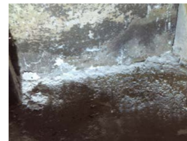
Saltutslag på gulv og vegg i mindre bod.
