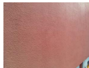
Deler av pusset fasade.
