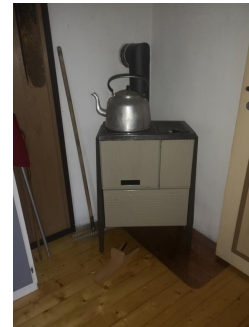
Vedovn i gang med for liten ubrennbar plate på gulv.
