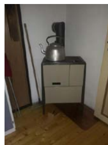
Vedovn i gang med for liten ubrennbar plate på gulv.
