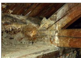
Del av knebukk på bygårdloft med kraftig angrep av ekte hussopp. Soppen sees på bildet i form av hvitt overflatemycel og som lyse mycelstrenger.
