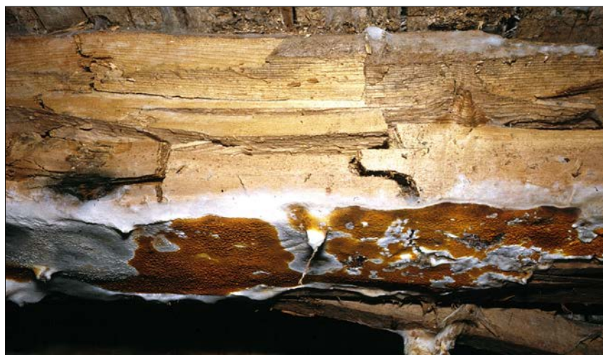
Råteskade i gulvbjelke forårsaket av ekte hussopp. Det rødbrune fruktlegemet sitter under bjelken. Typisk er at det dannes store sprekkeklosser i det angrepne trematerialet.
