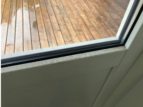
Skade i karm, altandør
