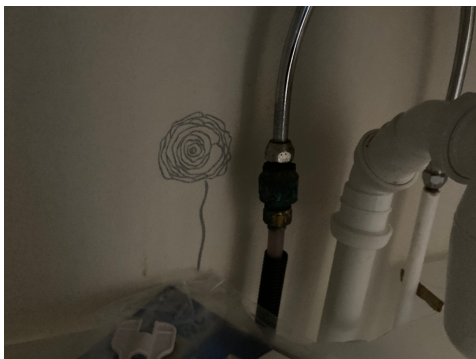
Mangler endekappe på rør
