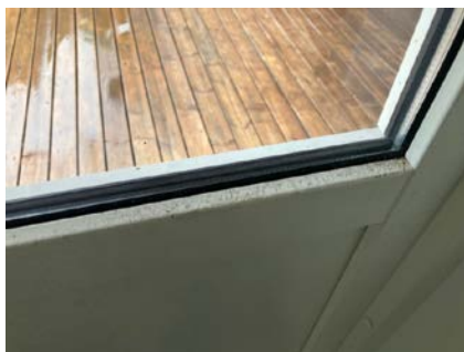
Skade i karm, altandør
