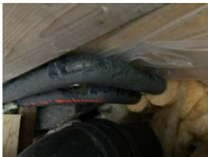
Musegang på isolasjon
