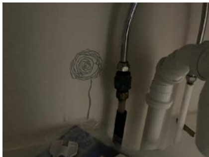
Mangler endekappe på rør
