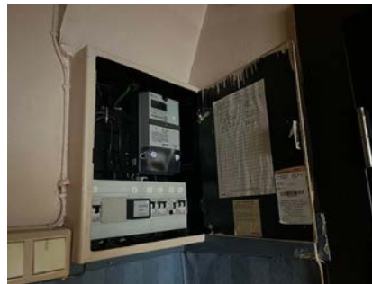
Sikringskap plassert i entre.
