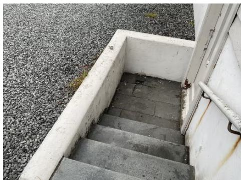
Det er ikke montert rekkverk på trappevange for kjellertrapp.
