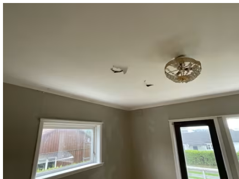
Skader i tak.
