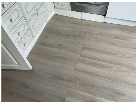
Laminat er ikke fagmessig montert (manglende skjøter i forband).
