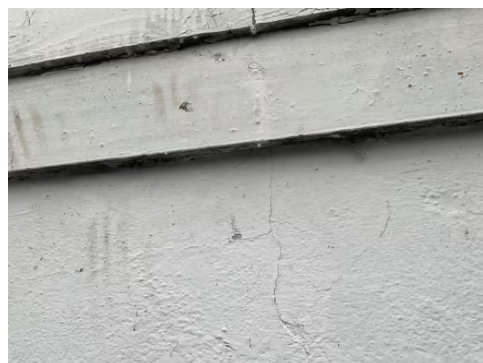
Begrenset lufting rundt deler av grunnmur pga. kledning ligger mot grunnmuren.
