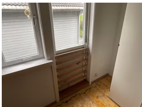
Mangelfull sikring av balkongdør.
