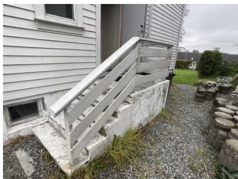
Horisontale åpninger i rekkverk er for store.
