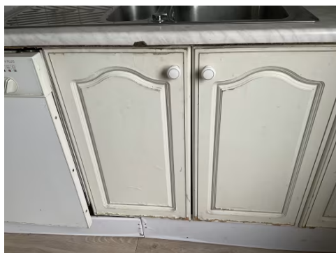
Kjøkkeninnredningen har store skader.
