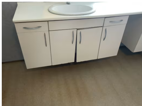
Baderoms innredningen har store skader.
