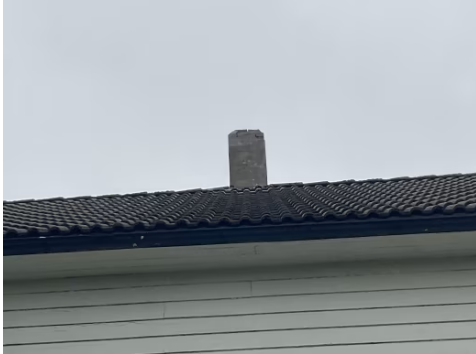
Det er pussavskalling og kraftig slitasje på pipa over tak.
