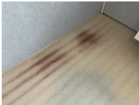
Misfarging i belegg fra varmekabler.
