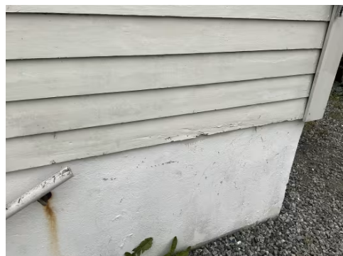
Det registreres stedvis råteskader i trekledning.
