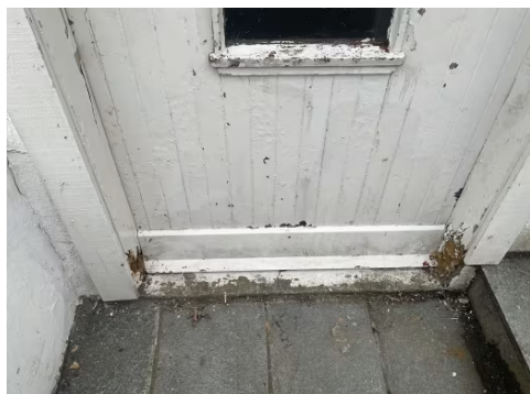
Det registreres råteskader i karmen.
