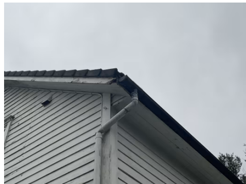
Det registreres stedvis råteskader i trekledning og vindskier.
