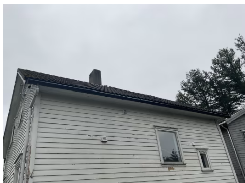
Noe nedbøy i yttertak
