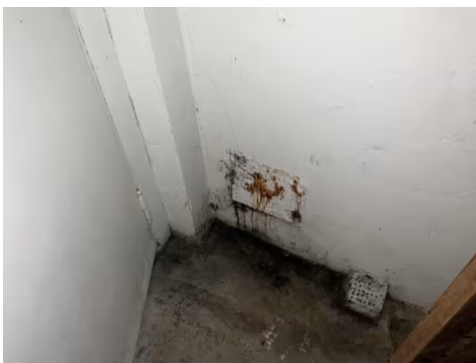
Det trekker noe sotvann fra sotluke i kjeller.
