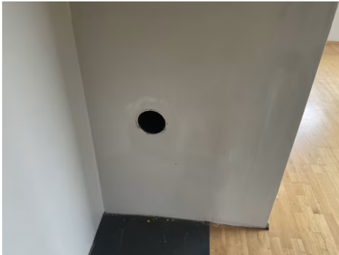
Ovnslør i pipe i stue er ikke blendet etter ildsted ble fjernet.
