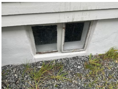
Det registreres råteskader i karmen.
