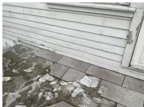
Liten avstand mellom kledning og terrasse.
