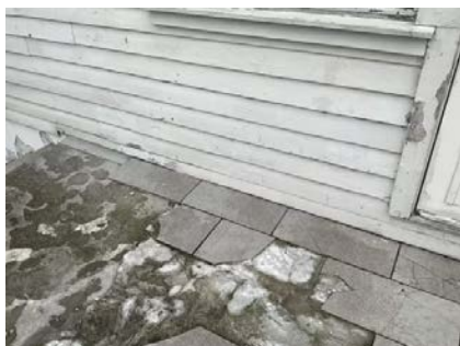
Liten avstand mellom kledning og terrasse.
