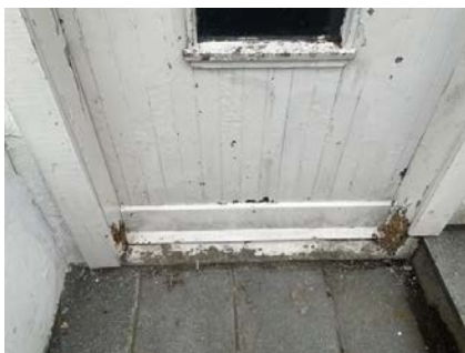
Det registreres råteskader i karmen.
