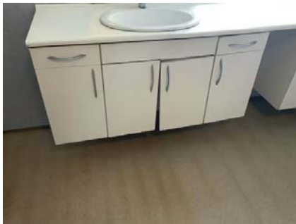
Baderoms innredningen har store skader.
