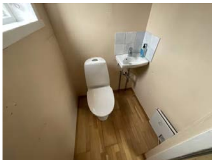
Det registreres svikt og fuktmerke i parkett.
