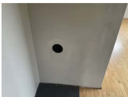
Ovnsrør i pipe i stue er ikke blendet etter ildsted ble fjernet.
