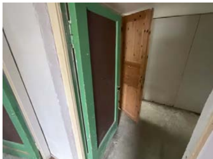
Innvendige dører er generelt noe slitt i finer og låskasser, dette er påregnelig normalt når dørene er av en viss alder.
