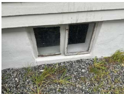
Det registreres råteskader i karmen.
