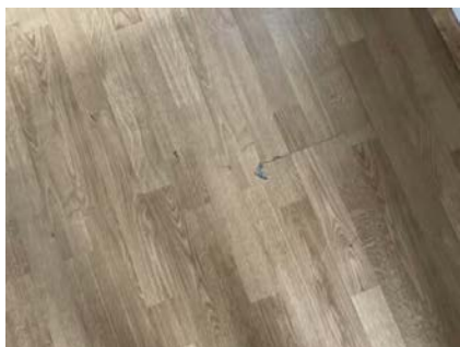
Skader i laminat.
