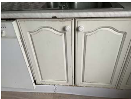
Kjøkkeninnredningen har store skader.
