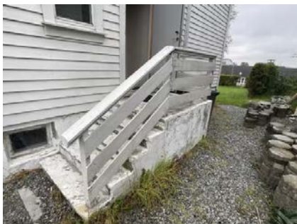
Horisontale åpninger i rekkverk er for store.
