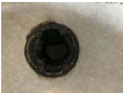
Plastsluk. Mer enn halvparten av forventet brukstid er passert på sluk og membranløsningen.
