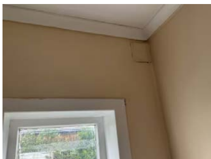
Toalettrom har kun naturlig avtrekk.
