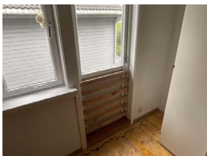
Mangelfull sikring av balkongdør.
