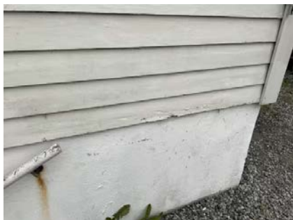
Det registreres stedvis råteskader i trekledning.
