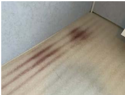
Misfarging i belegg fra varmekabler.
