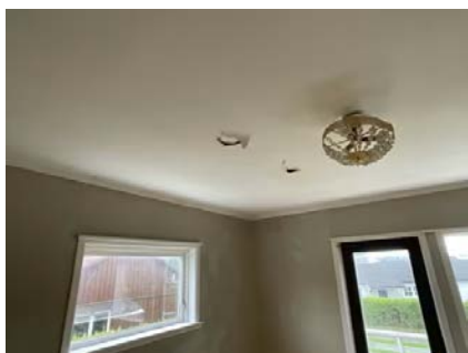
Skader i tak.
