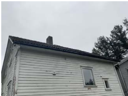
Noe nedbøy i yttertak
