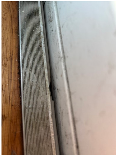
Utett dør. Trekk er observert.
