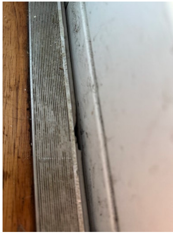
Utett dør. Trekk er observert.
