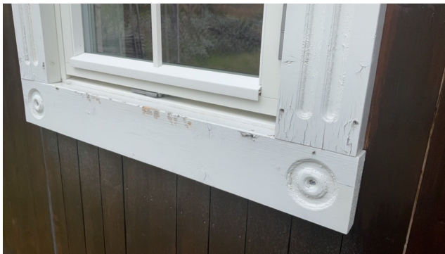
Vedlikeholdsbehov av enkelte vindu
