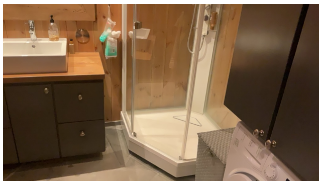
Trepanel på vegger i det som ansees som våtsone, men det er montert dusjkabinett
