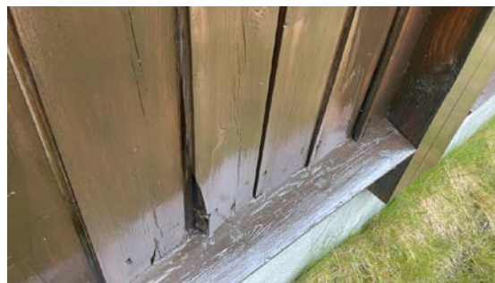
Bemerket kuling og skade på enkelte kledningsbord
