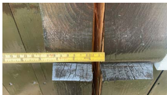
Sprekk i søyle
