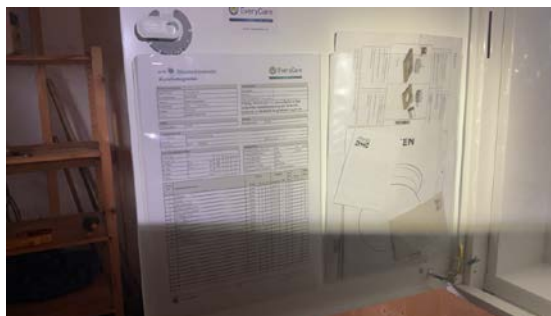
Foreligger kursfortegnelse, dokumentasjon av anlegget med sluttkontroll, samsvarserklæring, skjultvarme mm
