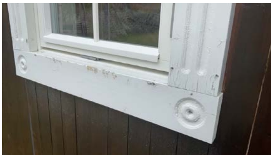
Vedlikeholdsbehov av enkelte vindu
