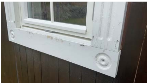
Vedlikeholdsbehov av enkelte vindu
