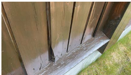
Bemerket kuling og skade på enkelte kledningsbord
