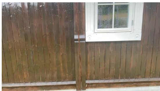
Sprekker i enkelte hjørnekasser/boks, to søyler målt sprekk på oppmot 2 cm der bør holdes under tilsyn
