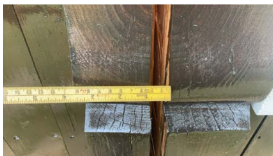
Sprekk i søyle
