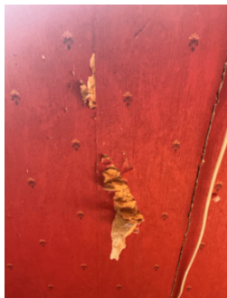
Overflateskade på vegg i soverom.
