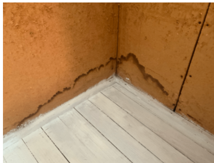
Fuktskjolde på vegg i garderobeskap på soverom.
