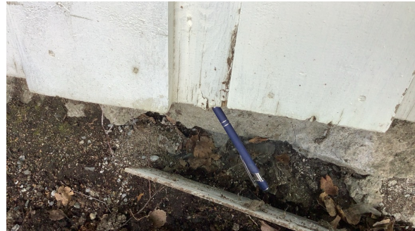
Småsprekker og råte enkelte plasser på kledning.
