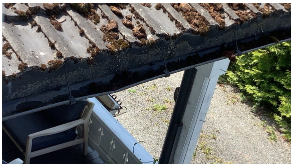
Bulk på takrenne.
