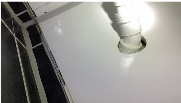
Utett gjennomføring i vegg.
