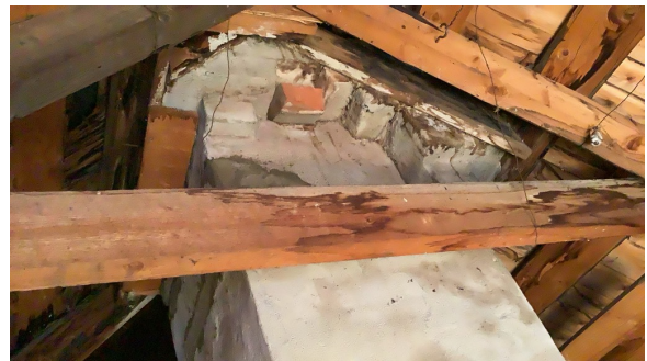
Fuktmerker rundt gjennomføring.
