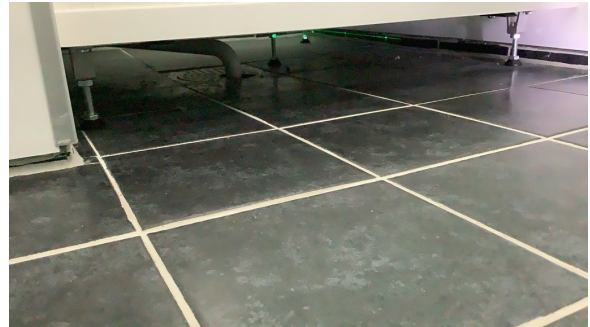
Slukområdet har noe lokalt fall mot sluk.
