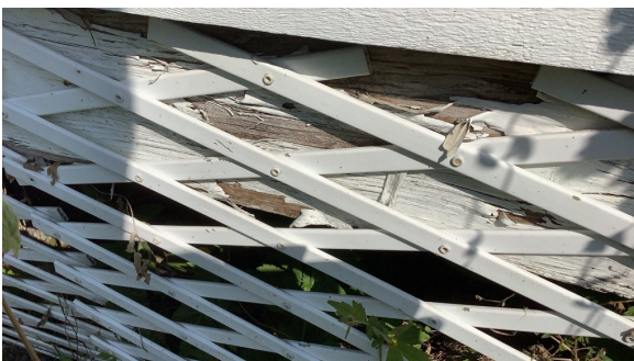
Konstruksjonene har vedlikeholdsbehov.
