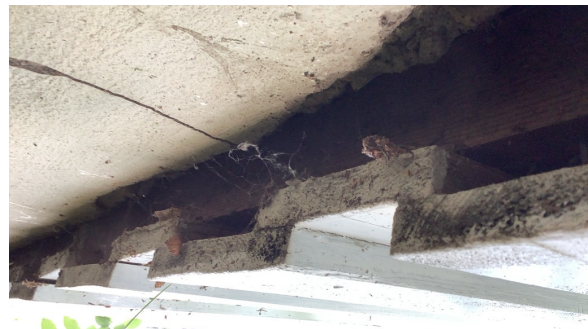
Manglende musesikring bak kledning.
