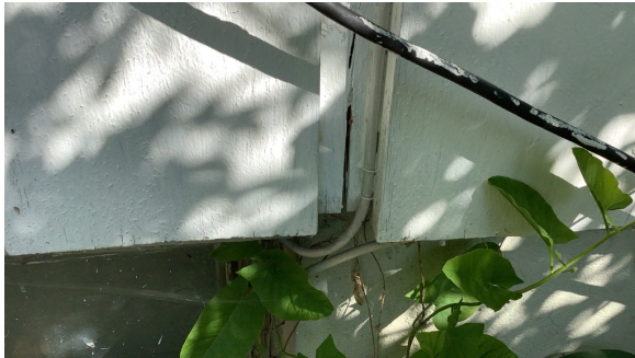
Sprekker i puss på grunnmur.
