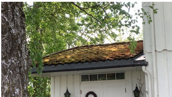
Mose på tak anbefales fjernet.
