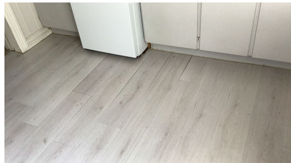
Laminat har svulmet etter fuktpåkjenning på kjøkken.
