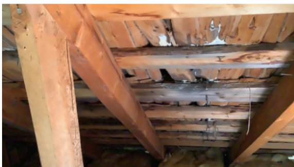
Det er råte og fuktskader i eldre undertak
