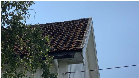
Vinds kier er værslitt.
