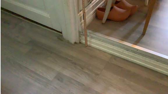
Det er høydeforskjell på gulv i hall.
