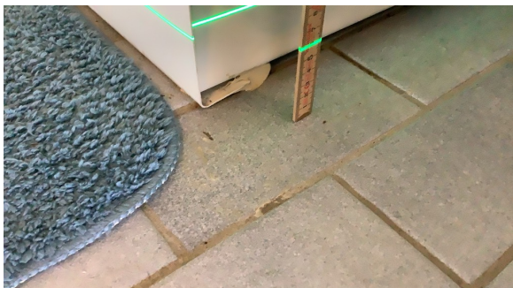
Fall er målt kun utenfor kabinett da dette var fastlimt til gulvet.
