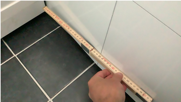
Plater er løsnet fra vegg.
