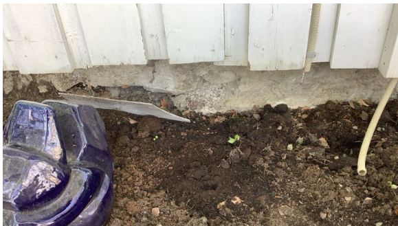
Kledningsbord er ikke kappet i lik høyde. Eternittplate mot del av mur som forvitret.
