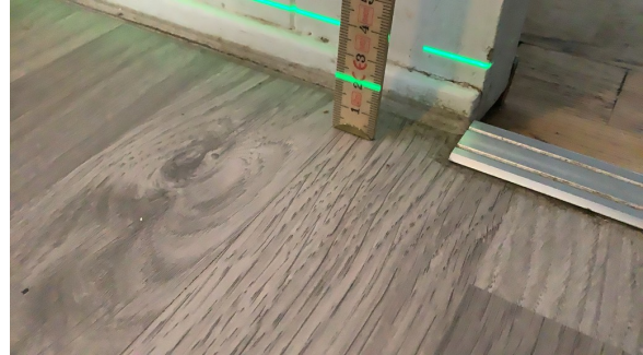
Det er 19 mm høydeforskjell på gulvet i kjøkken.
