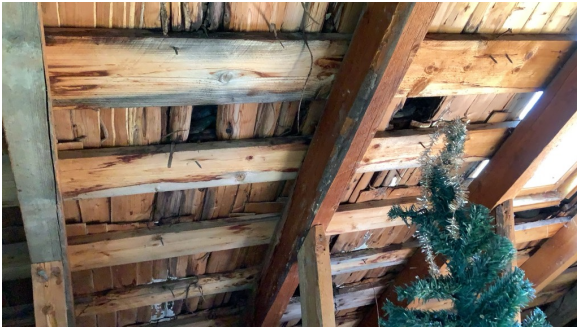
Eldre flistak er gjenbrukt som undertak. Dette er ikke tett.
