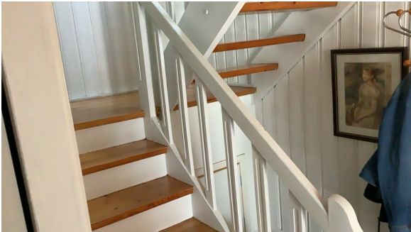
Trapp mellom 1. og 2. etasje har større åpninger enn dagens krav.
