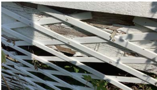
Konstruksjonene har vedlikeholdsbehov.
