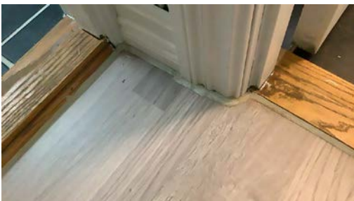
Laminat er ikke lagt under lister og gerikter.
