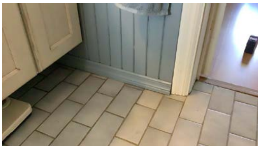
Uegnet overflate i våtsone.
