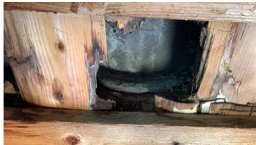
Åpning i undertaket etter tidligere lufting av avløp.
