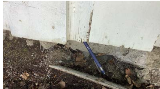
Småsprekker og råte enkelte plasser på kledning.
