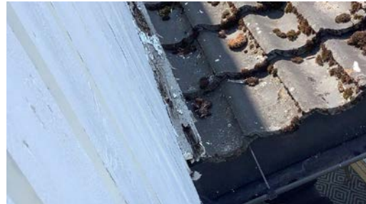
Råte i tre-vannbrett i overgang vegg tak.
