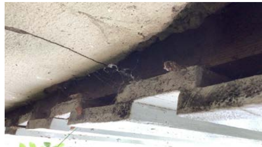
Manglende musesikring bak kledning.
