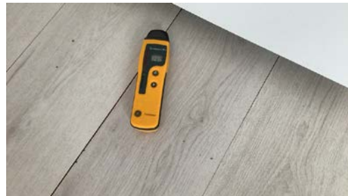
Skader i laminatgulv etter vann fra kjøleskap. Området var tørt på befaringen.
