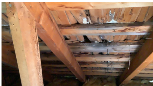
Det er råte og fuktskader i eldre undertak
