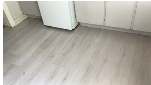
Laminat har svulmet etter fuktpåkjenning på kjøkken.
