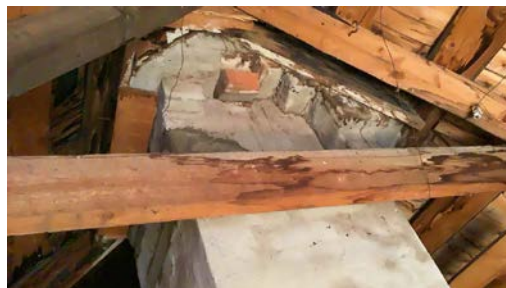
Fuktmerker rundt gjennomføring.
