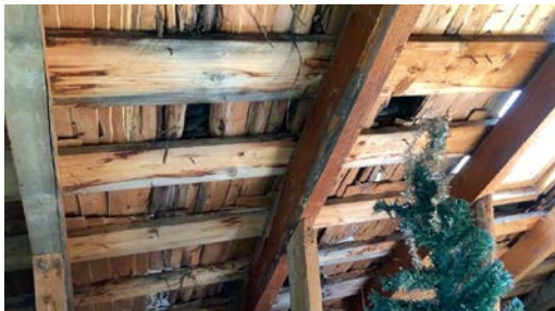
Eldre flistak er gjenbrukt som undertak. Dette er ikke tett.
