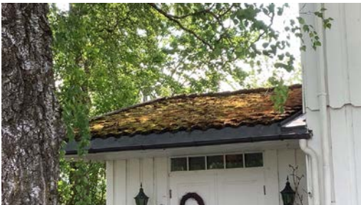
Mose på tak anbefales fjernet.
