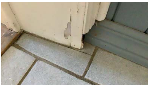
Sprekk i flis.
