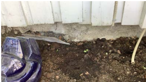
Kledningsbord er ikke kappet i lik høyde. Eternittplate mot del av mur som forvitrer.
