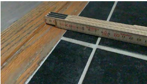
Det er ikke oppkant av membran mot terskel.
