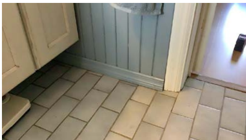
Uegnet overflate i våtsone.
