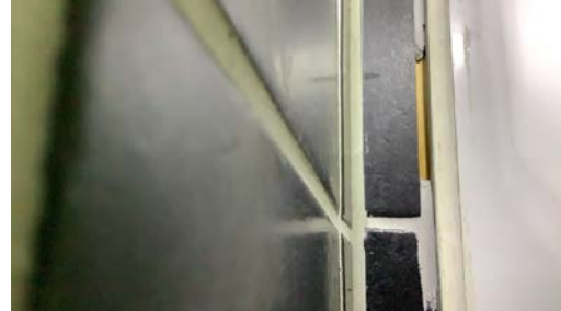
Manglende fuge mellom sokkelflis og veggplater
