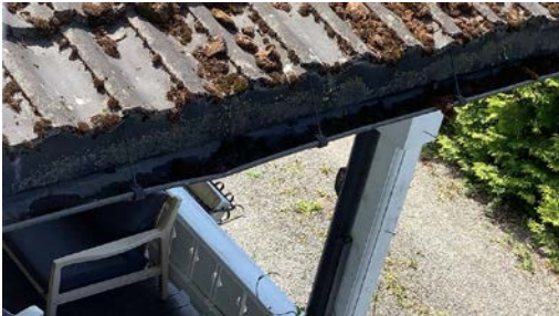
Bulk på takrenne.
