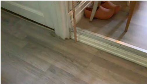
Det er høydeforskjell på gulv i hall.
