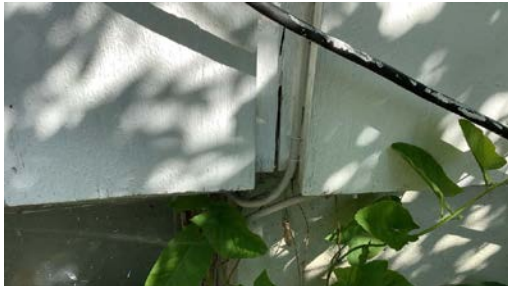
Sprekker i puss på grunnmur.
