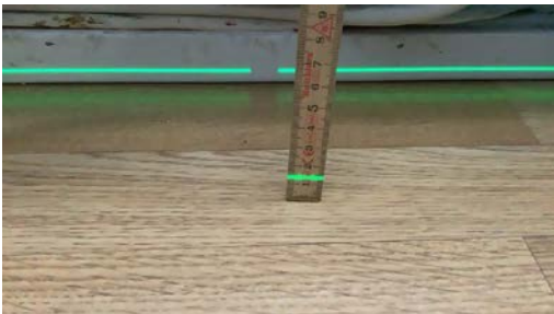
Det er målt høydeforskjell på 25 mm på soverom mot vest i 2. etasje.
