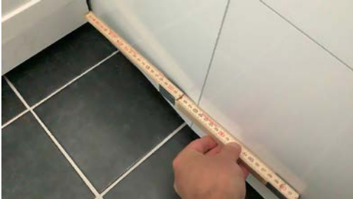
Plater er løsnet fra vegg.
