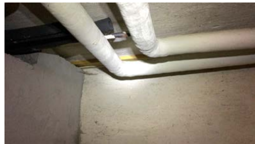
Anbefaler å sjekke om det er asbest i isolasjonen rundt varmerør, hvis man tenker å fjerne/demontere fyrkjel/radiatorer.
