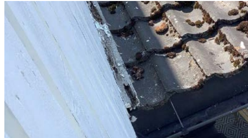
Råte i tre-vannbrett i overgang vegg tak.
