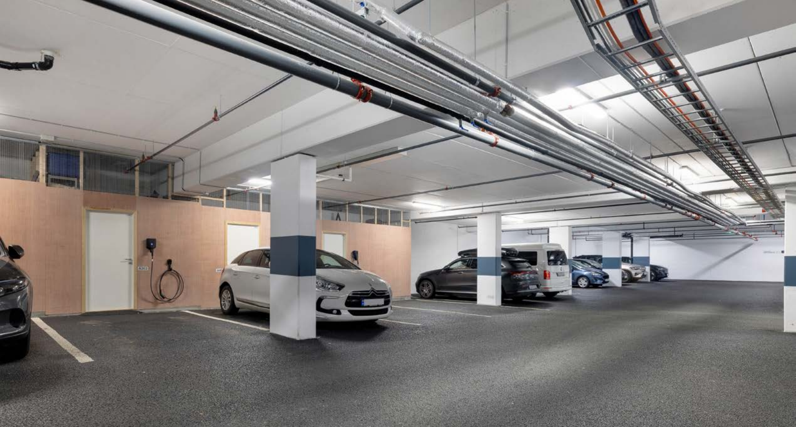
Parkeringsplass med bod i bakkant - elbil lader montert.
