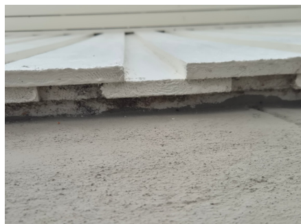
Ingen lufting i nedre del av kledningen.
