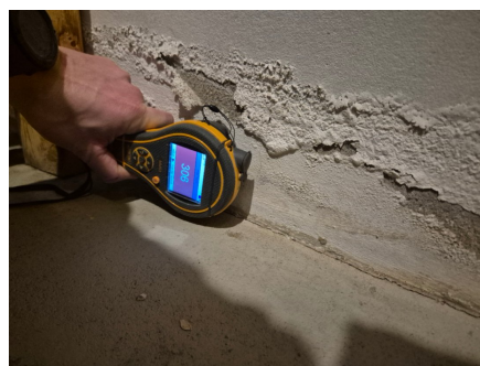
Synlig saltutslag i bod.
