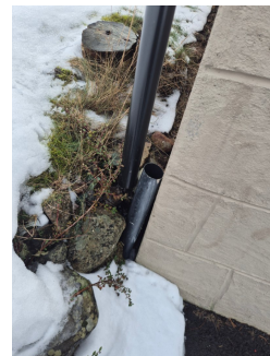
Nedløpsrør er ikke ført til oppstikkende drenerør.
