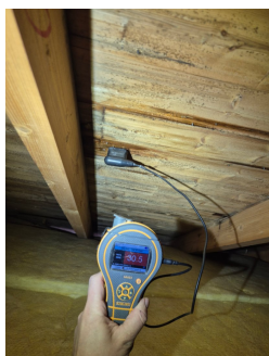
Vått treverk på loft etter lekkasje fra takshingel.
