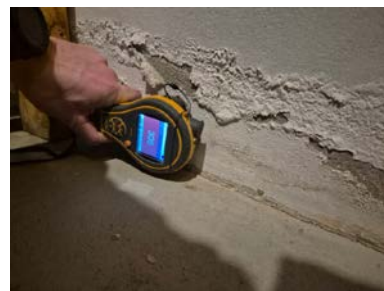
Synlig saltutslag i bod.
