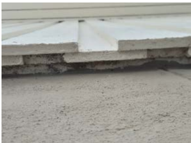
Ingen lufting i nedre del av kledningen.
