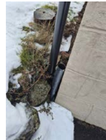
Nedløpsrør er ikke ført til oppstikkende drensrør.
