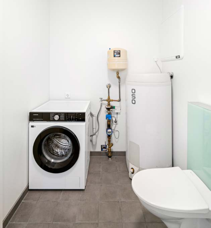
Baderommet kombineres også som vaskerom med opplegg til vaskemaskin.
