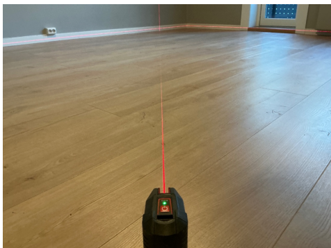
Nivellering stue, avvik ca. 10-20 mm
