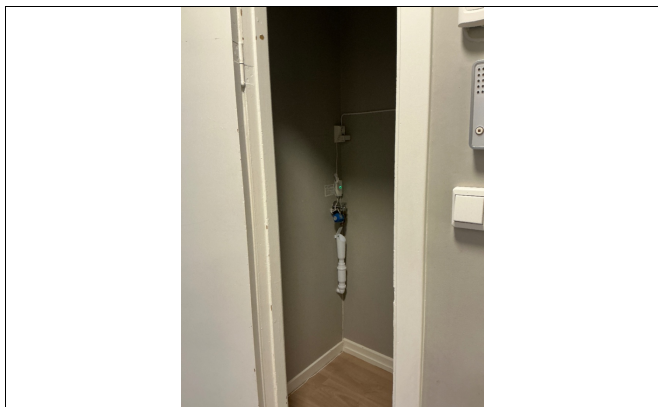
Opplegg for vaskemaskin med vannstoppesystem i kott.
