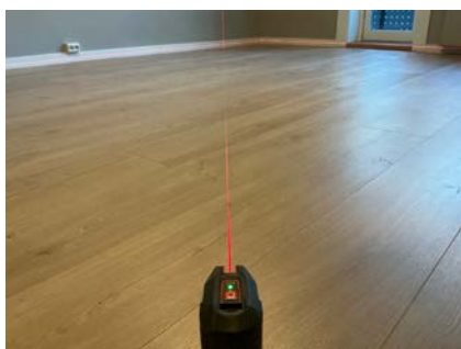
Nivellering stue, avvik ca. 10-20 mm
