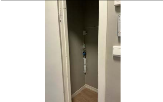
Opplegg for vaskemaskin med vannstoppesystem i kott.
