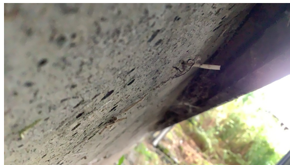
Redusert lufting ifht dagens krav.
