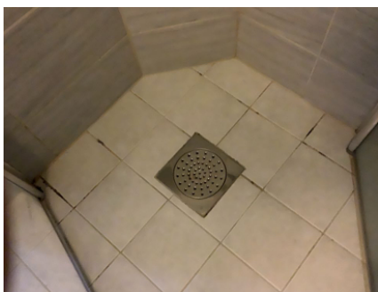
Svertesopp i fuger er registrert.
