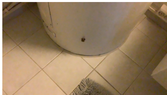
Varmtvannsbereder er silikonet fast mot gulv. Ukjent løsning. Anbefaler videre undersøkelser.
