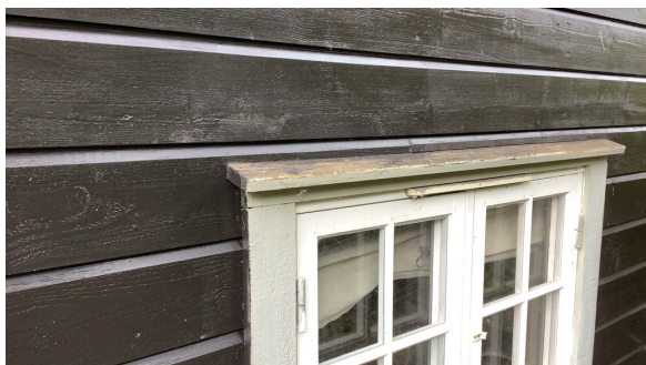
Det er manglende beslag/vannbrett inn bak kledning over vinduer
