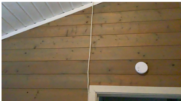
Manglende/ufagmessig klamring av ledninger.
