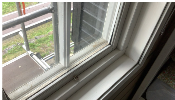
Kondensmerker innvendig og mellom ruter.
