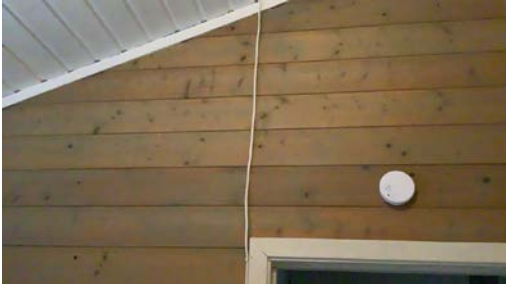
Manglende/ufagmessig klamring av ledninger.
