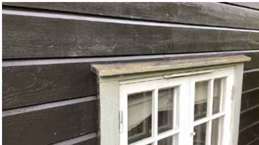
Det er manglende beslag/vannbrett inn bak kledning over vinduer
