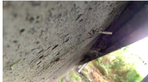
Redusert lufting ifht dagens krav.
