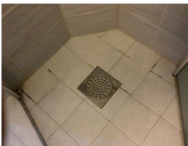
Svertesopp i fuger er registrert.
