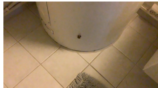
Varmtvannsbereider er silikonet fast mot gulv. Ukjent løsning. Anbefaler videre undersøkelser.
