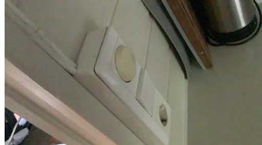
Det er løs dekkning rundt bryter.
