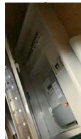
Vanskelig tilkomst til skap, da det er plassert reol på boden.
