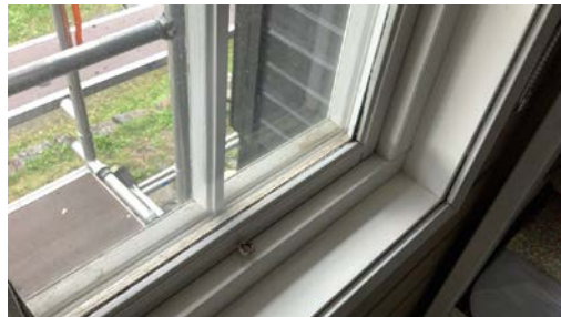
Kondensmerker innvendig og mellom ruter.
