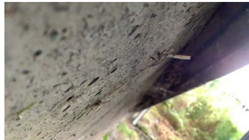
Redusert lufting ifht dagens krav.
