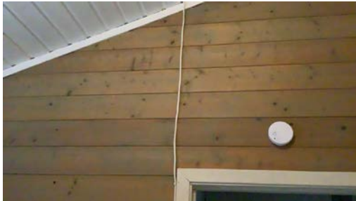
Manglende/ufagmessig klamring av ledninger.
