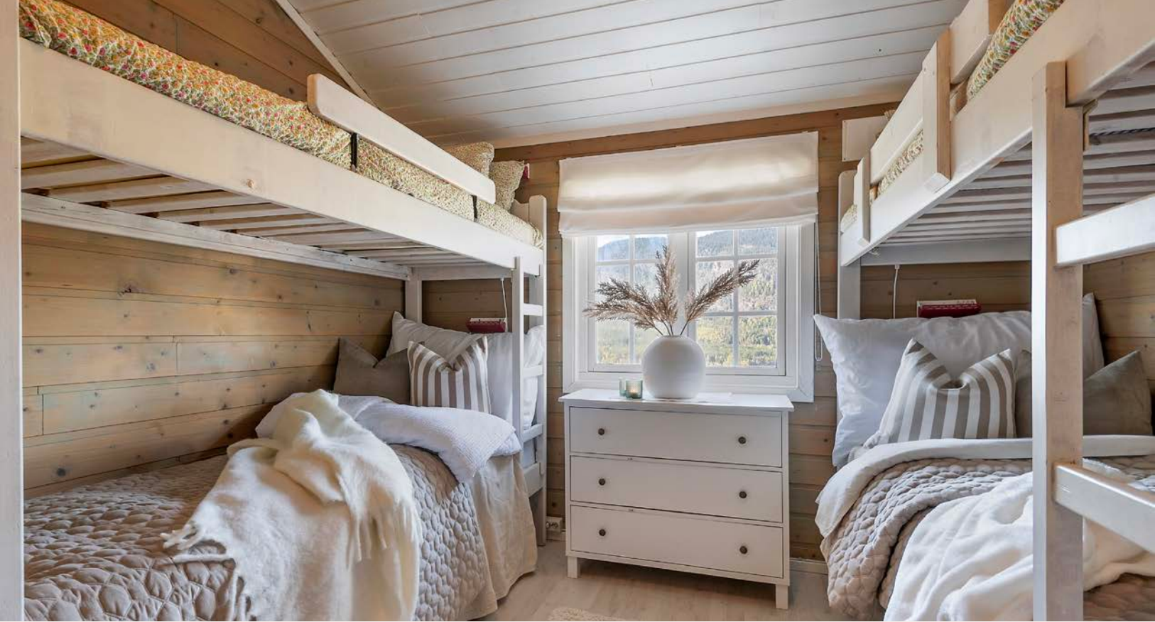
Soverom II. Ikke godkjent rømningsvindu.
