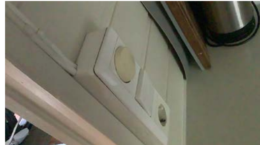
Det er løs dekkning rundt bryter.
