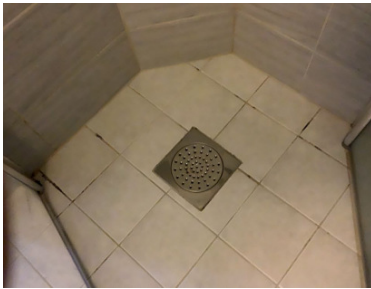
Svertesopp i fuger er registrert.
