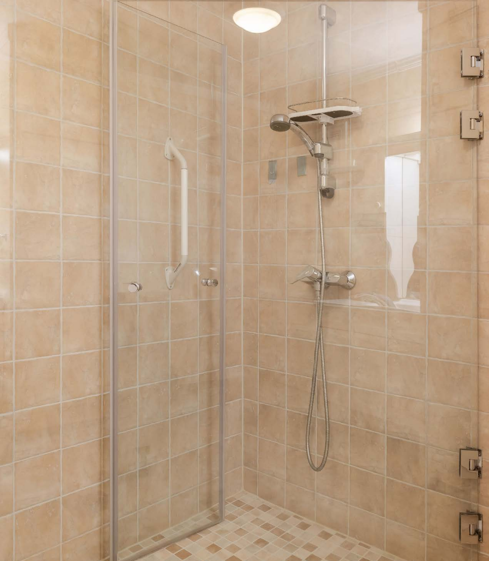
4370-3-1_041.jpg Dusjhjørne med innfellbare dusjdører og vegghengt dusjbatteri.
