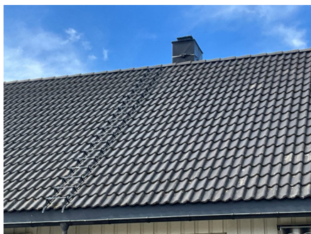
Manglende snøfangere og jekkestropp rundt pipe.
