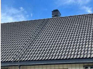
Manglende snøfangere og jekkestropp rundt pipe.
