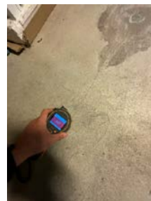
Riss i betonggolv og indikasjoner på fuktopptrekk fra grunnen.
