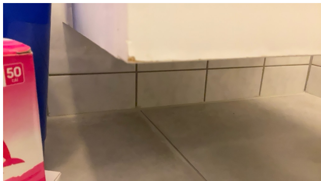
Fuktskader i nedkant av dør
