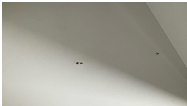
Utsvelt bunnplate, skader på overflater
