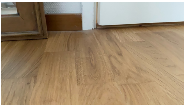
Dør til soverom tar i terskel
