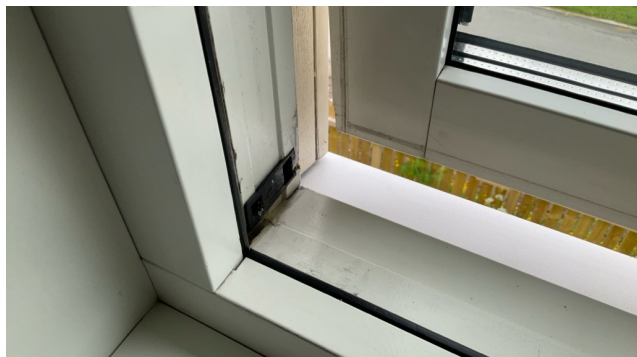
Skade på vinduskarm på soveromsvindu
