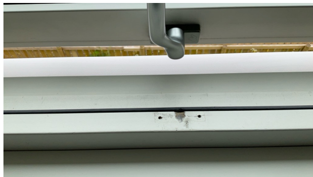
Skade på vinduskarm på soveromsvindu
