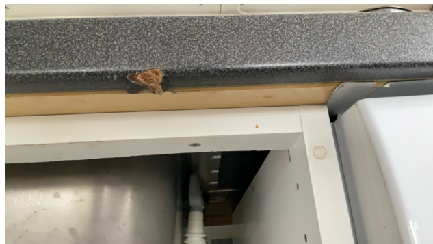
Skade på benkeplate
